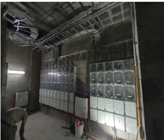
Sala de medidores eléctricos
